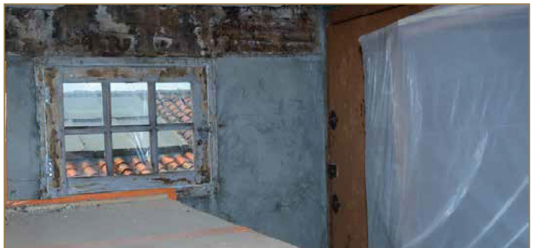
Mur sud altéré du petit musée aujourd'hui © Ville de Rochefort
